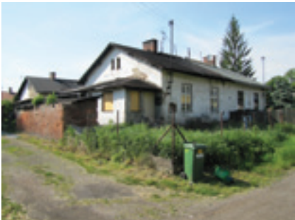
4 Zabedněná okna, disfunkční střešní konstrukce a popraskaná omítka. Nová Alexandrova kolonie v Kunčičkách nabízí nemálo obdobných exemplářů, které jsou stále obývané. (foto: Martin Náhlovský)
